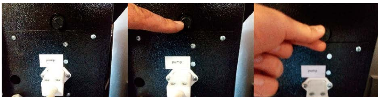
Figure 33: Activarea siguranței termice
